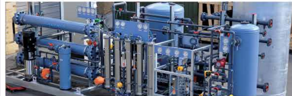
Unite de Traitement d'Eau Industrielle 10000LPH
